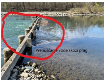
Poškodovan zajezni prag
