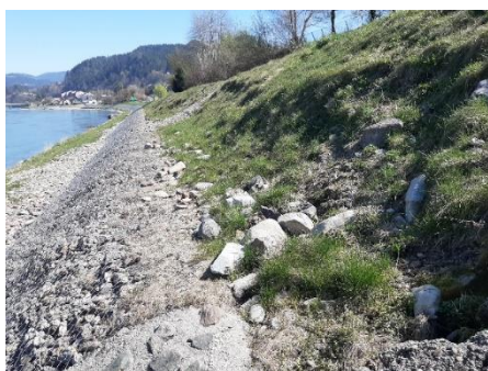
Poškodba brežine nad gabioni
