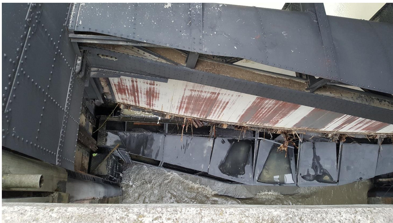
POŠKODOVANA ZGORNJA ZAPORNICA PRETOČNEGA POLJA ŠTEVILKA 4 HE MARIBORSKI OTOK
