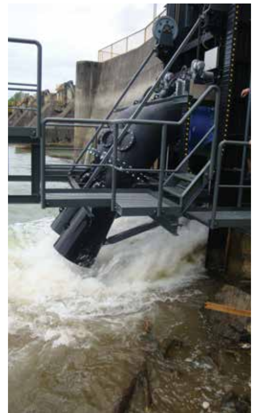
DVIG ZAPORNICE Z NAMEŠČENIMA AGREGATOMA
