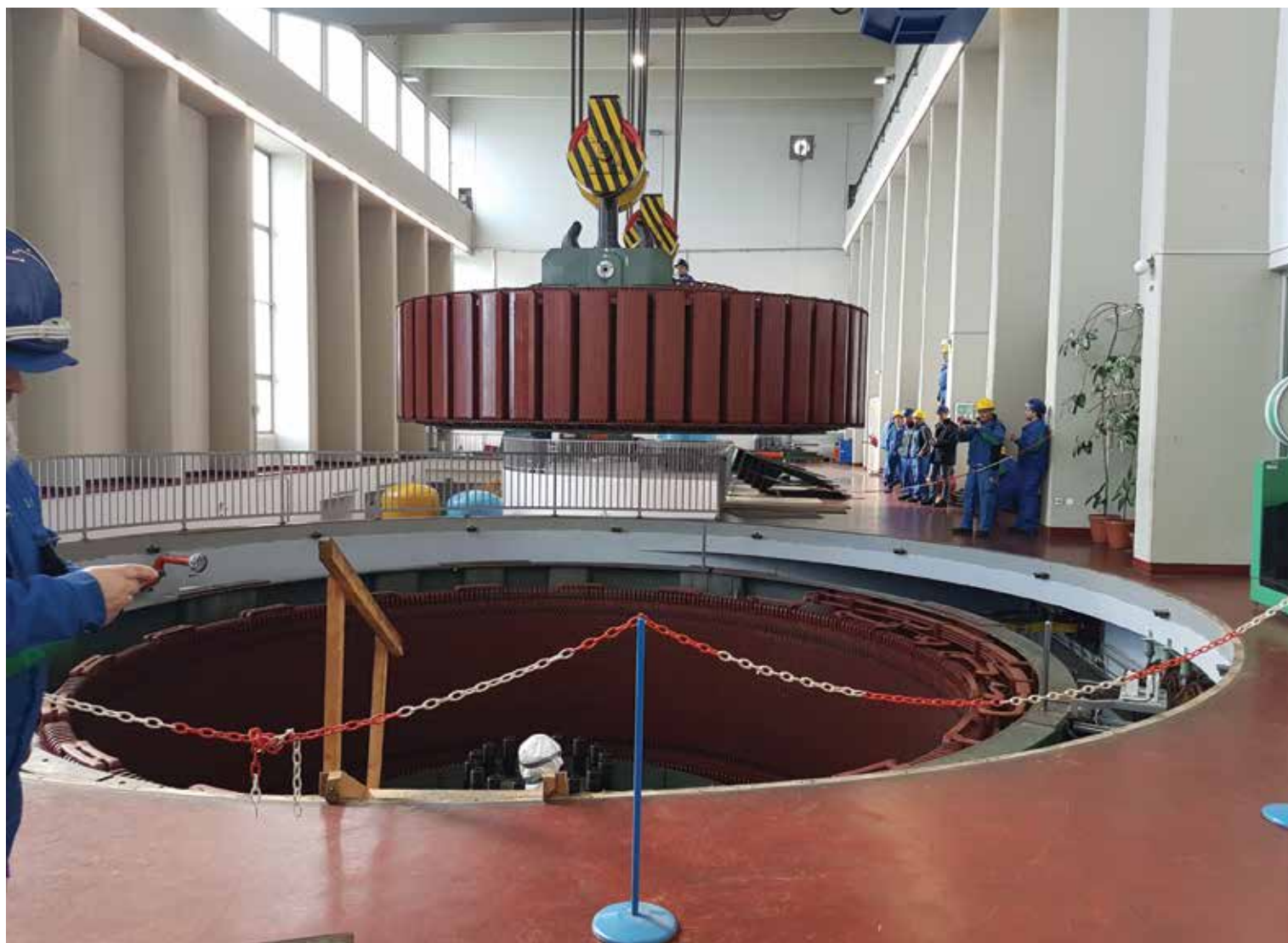
NOTRANJOST HIDROELEKTRARNE FORMIN
