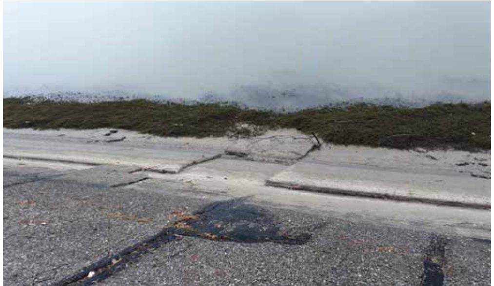
Poškodovana asfaltna obloga na levi strani Ptujškega jezera.
